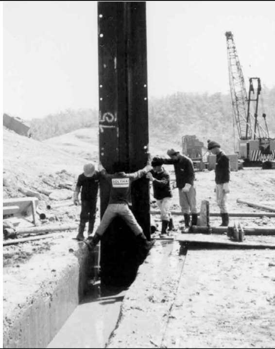
การติดตั้ง Stopend ก่อนที่จะเท Backfill Material
